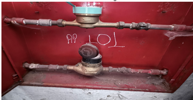
Contador de Agua
