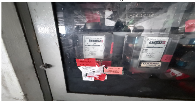
Contador de Energia
