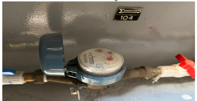
Contador de Agua
