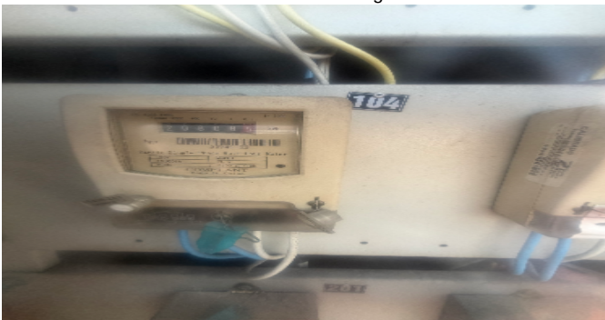
Contador de Energia
