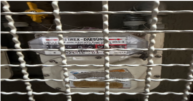
Contador de Gas
