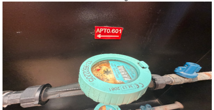
Contador de Agua
