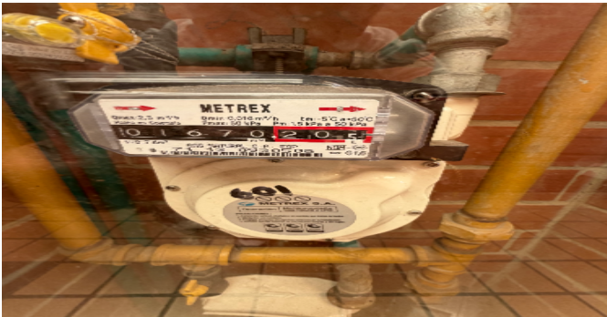
Contador de Gas
