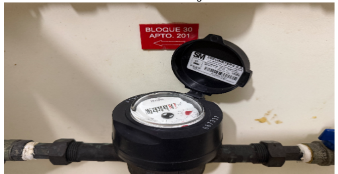
Contador de Agua
