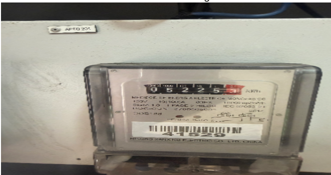
Contador de Energia
