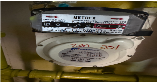
Contador de Gas
