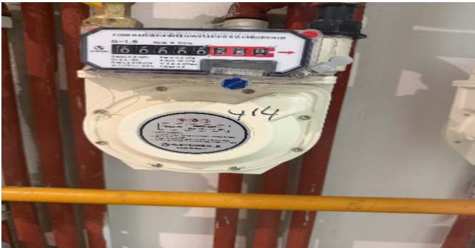
Contador de Gas
