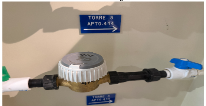
Contador de Agua
