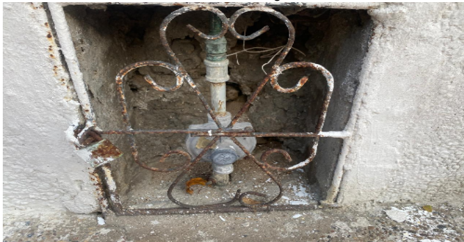
Contador de Agua
