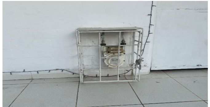
Contador de Gas
