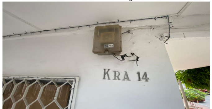
Contador de Energia
