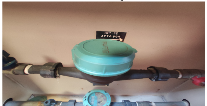
Contador de Agua
