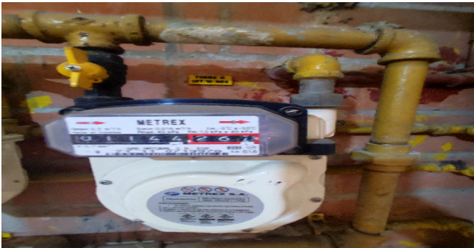
Contador de Gas
