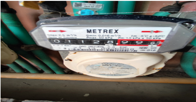
Contador de Gas
