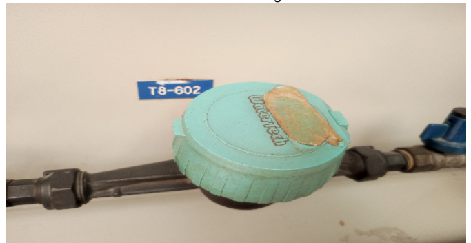
Contador de Agua
