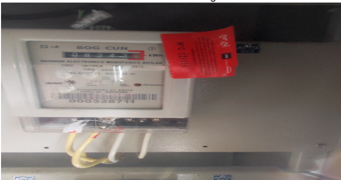
Contador de Energia
