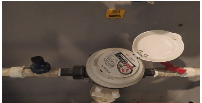
Contador de Agua
