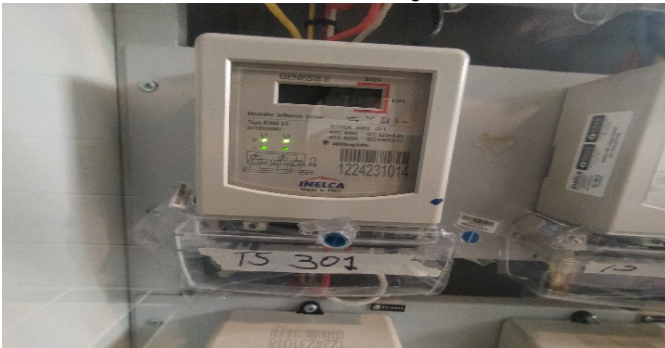
Contador de Energia
