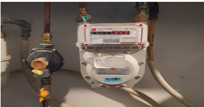
Contador de Gas
