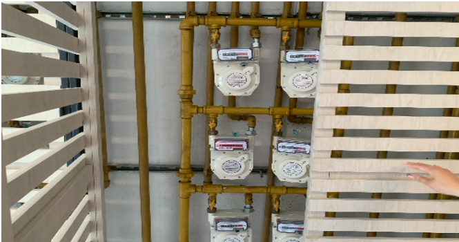
Contador de Gas
