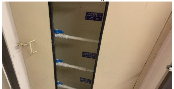
Contador de Agua
