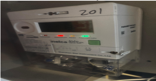
Contador de Energia
