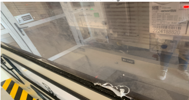
Contador de Energia
