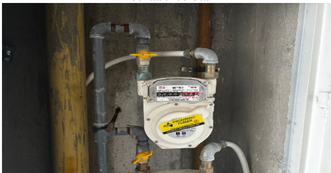
Contador de Gas
