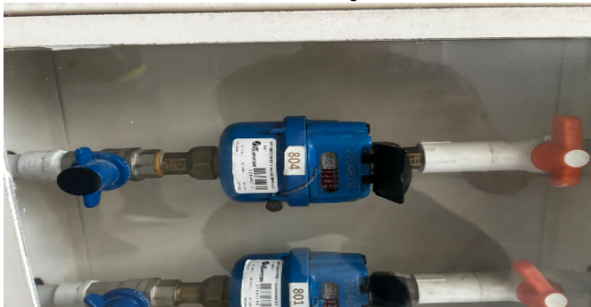
Contador de Agua
