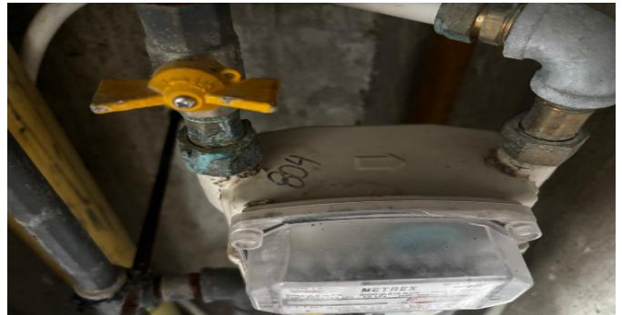
Contador de Gas
