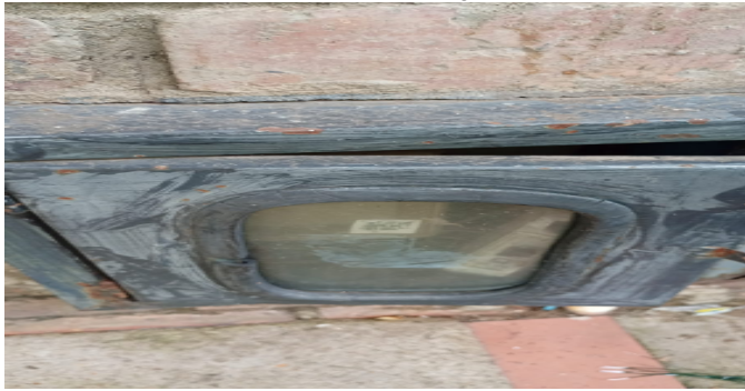
Contador de Energia
