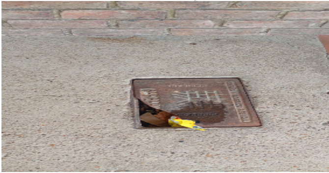
Contador de Agua
