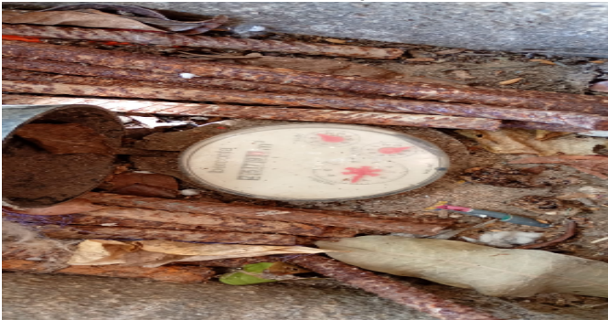
Contador de Agua
