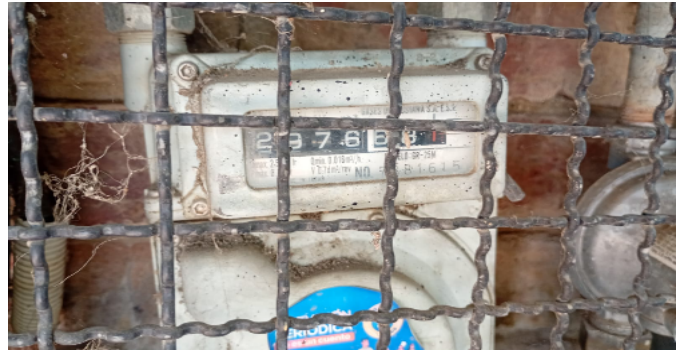
Contador de Gas
