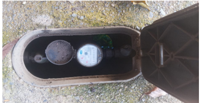
Contador de Agua
