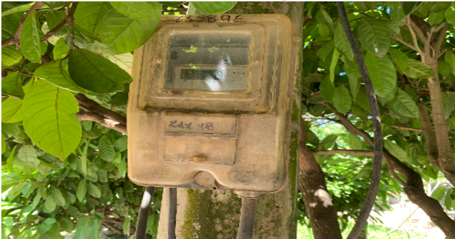
Contador de Energia
