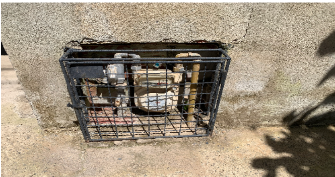
Contador de Gas
