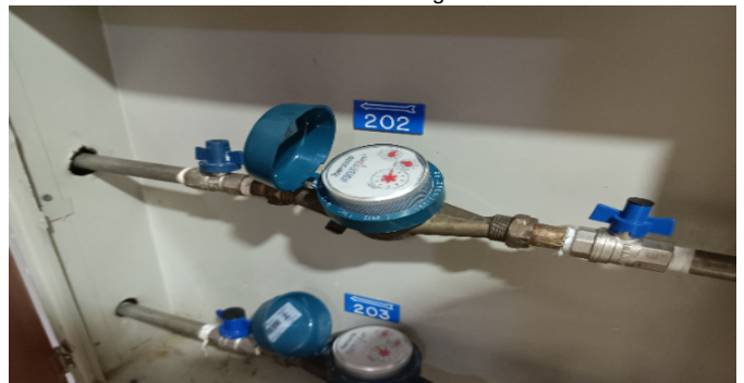
Contador de Agua
