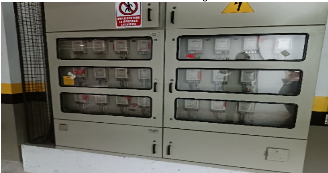
Contador de Energia
