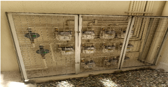
Contador de Gas
