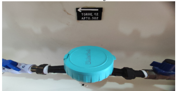
Contador de Agua
