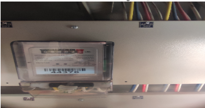
Contador de Energia
