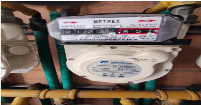
Contador de Gas
