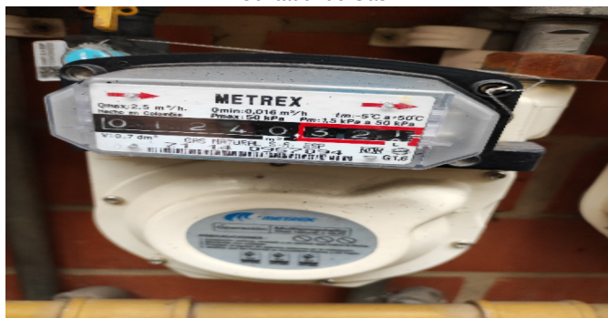
Contador de Gas
