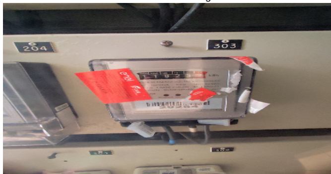
Contador de Energia
