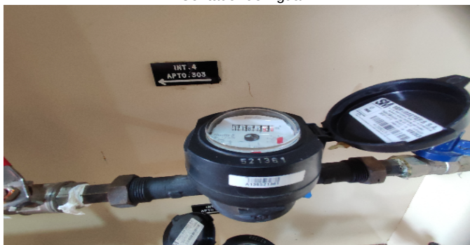
Contador de Agua
