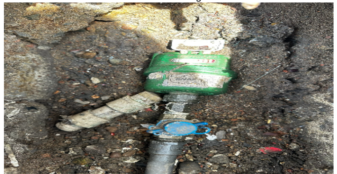
Contador de Agua
