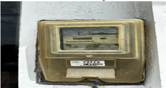
Contador de Energia
