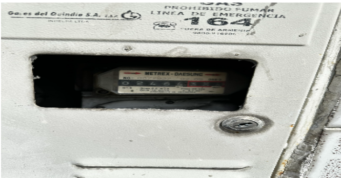
Contador de Gas
