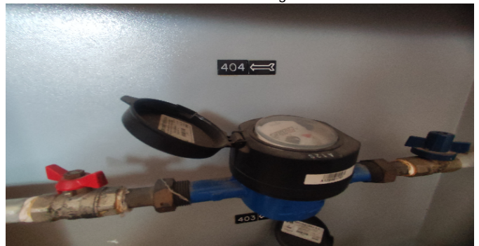
Contador de Agua
