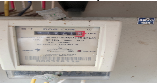
Contador de Energia
