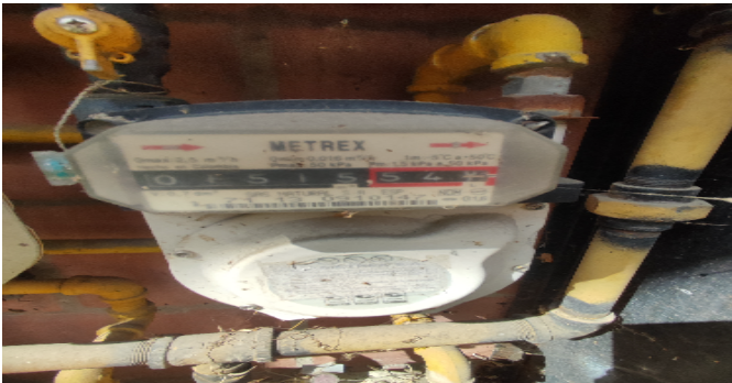
Contador de Gas
