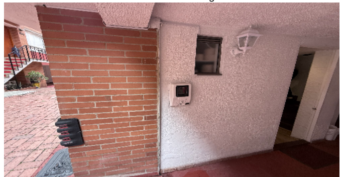
Contador de Energia
