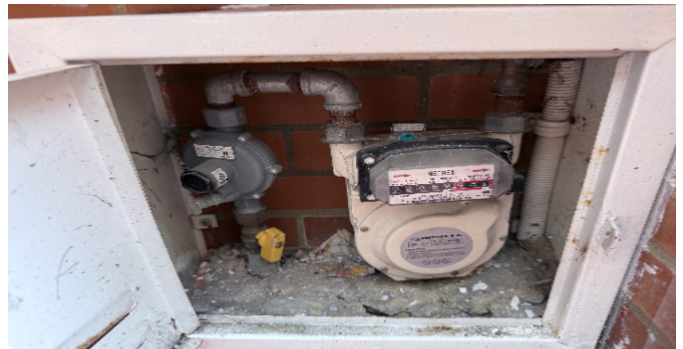
Contador de Gas
