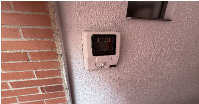
Contador de Energia
