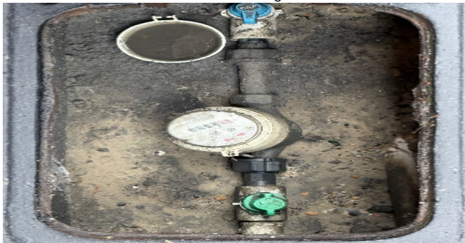
Contador de Agua
