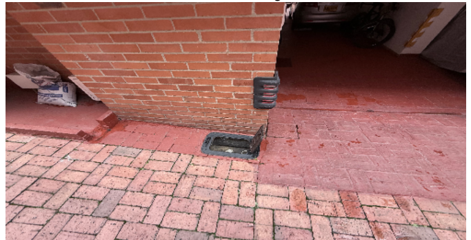
Contador de Agua
