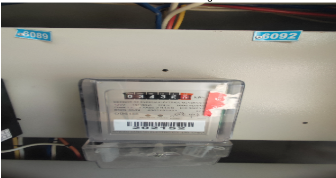
Contador de Energia
