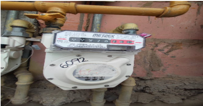
Contador de Gas
