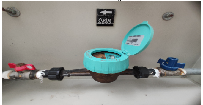
Contador de Agua
