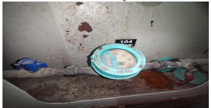
Contador de Agua
