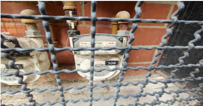
Contador de Gas
