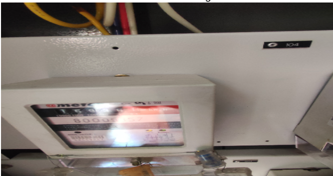
Contador de Energia
