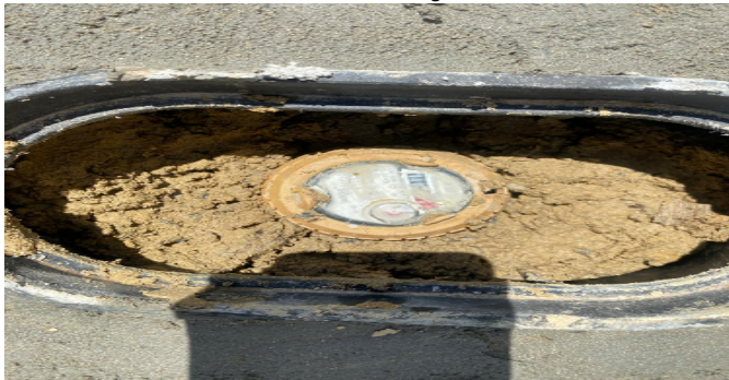
Contador de Agua
