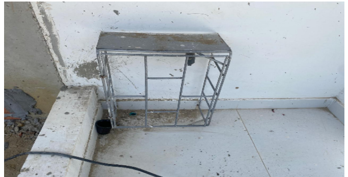
Contador de Gas
