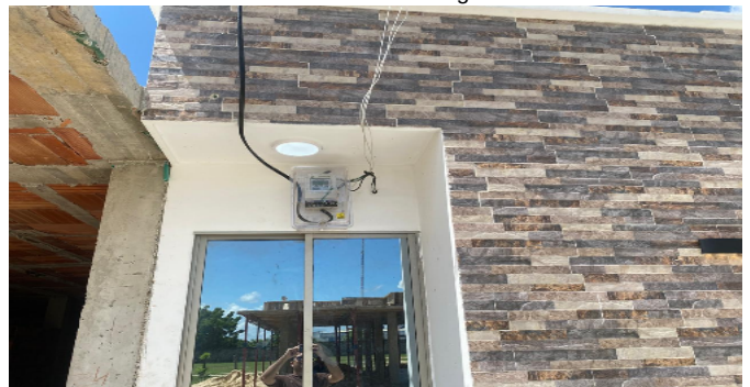
Contador de Energia
