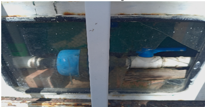
Contador de Agua
