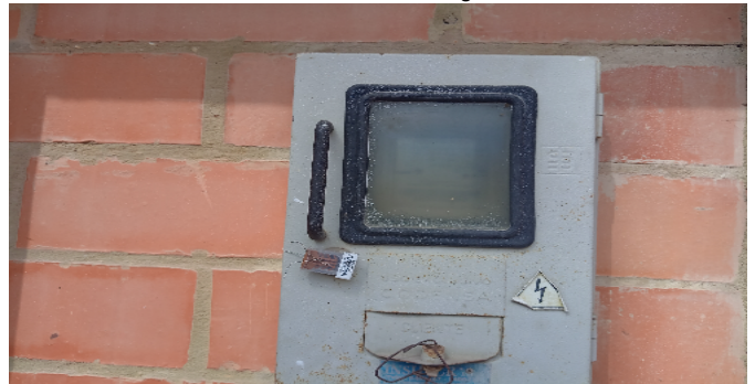
Contador de Energia
