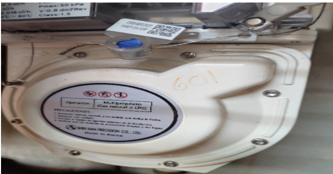
Contador de Gas
