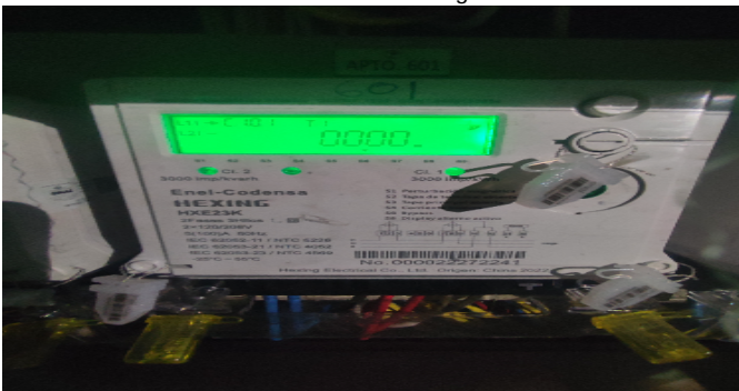
Contador de Energia
