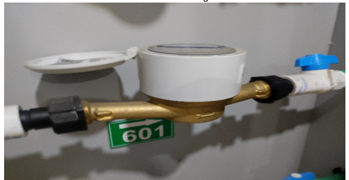
Contador de Agua
