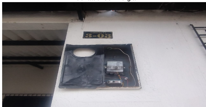
Contador de Energia
