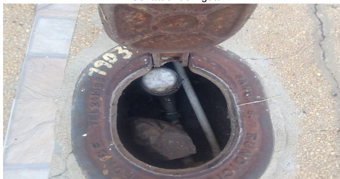
Contador de Agua
