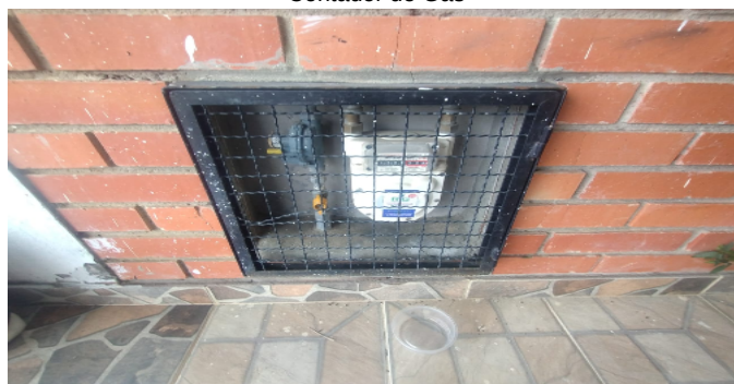
Contador de Gas
