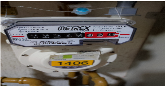
Contador de Gas
