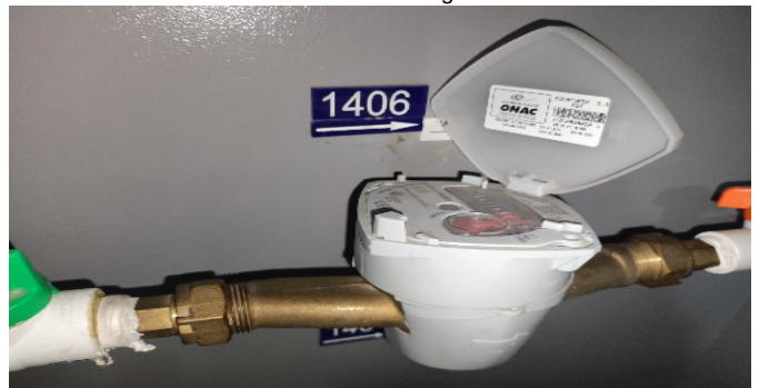
Contador de Agua
