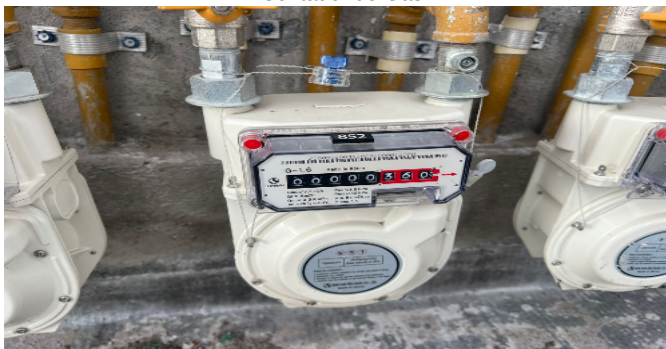
Contador de Gas
