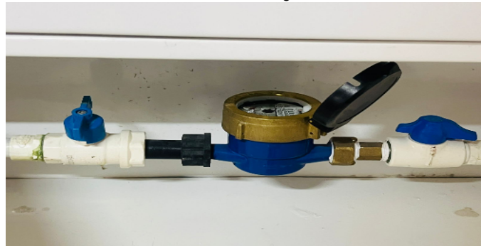
Contador de Agua
