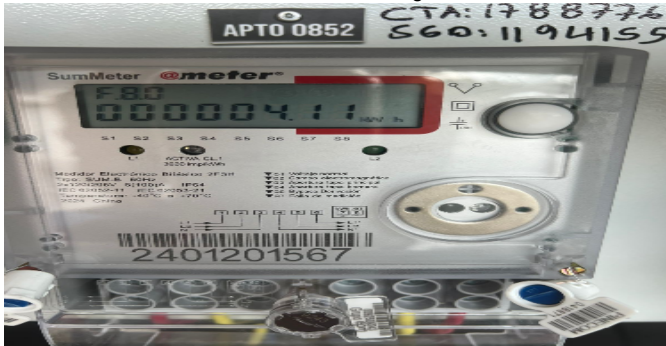
Contador de Energia
