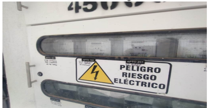
Contador de Energia
