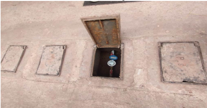
Contador de Agua
