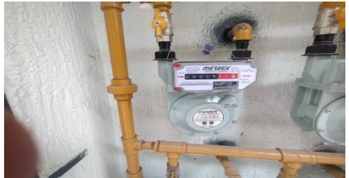
Contador de Gas
