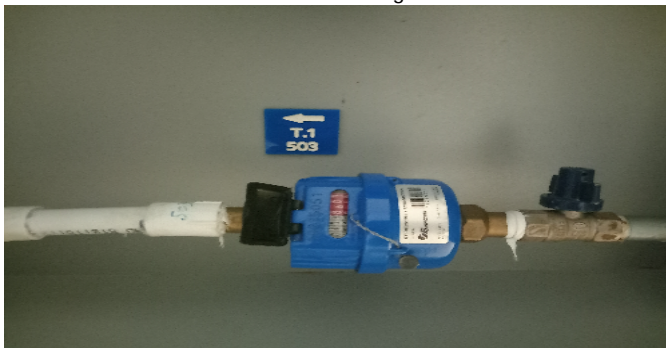
Contador de Agua
