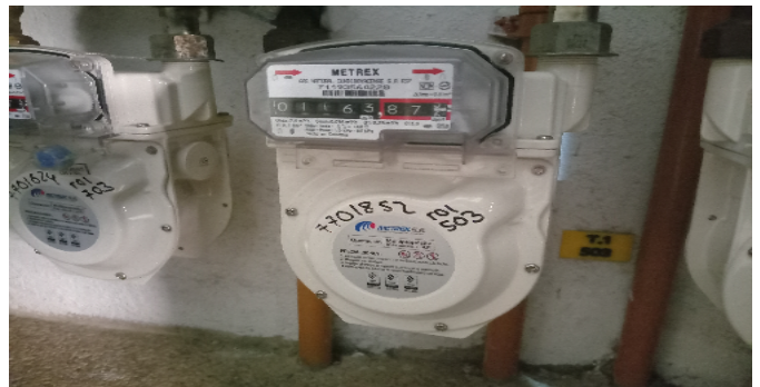
Contador de Gas
