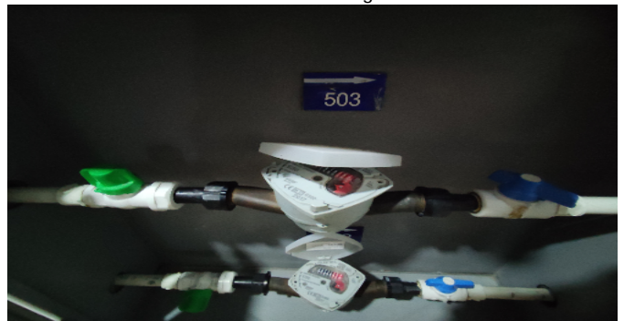
Contador de Agua
