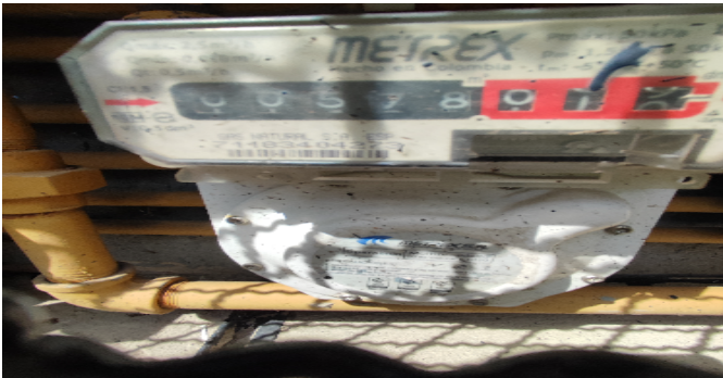
Contador de Gas
