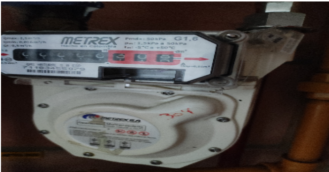
Contador de Gas
