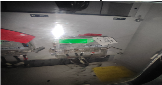
Contador de Energia
