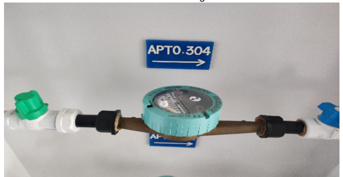
Contador de Agua
