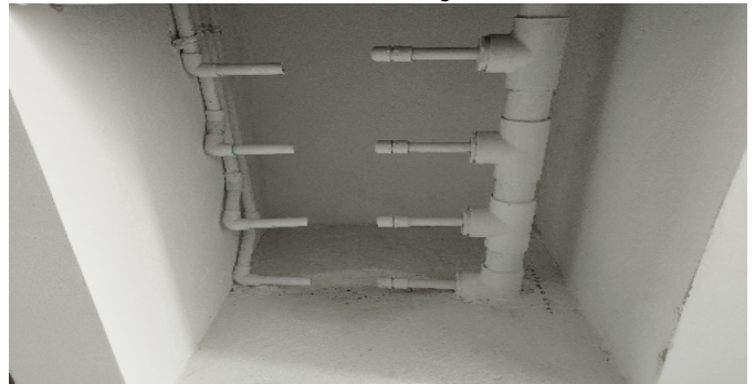
Contador de Agua
