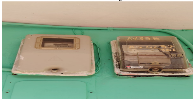
Contador de Energia
