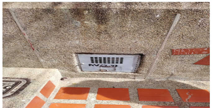
Contador de Gas
