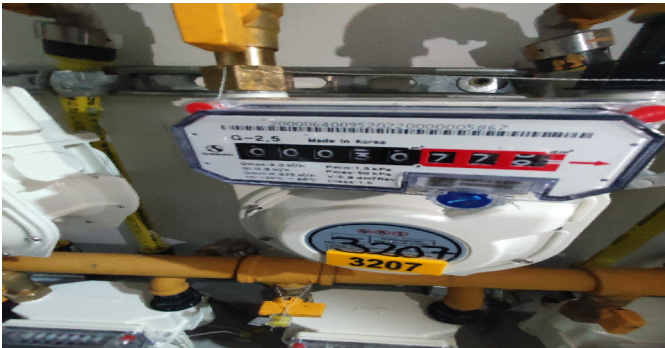
Contador de Gas
