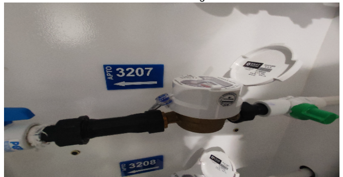
Contador de Agua
