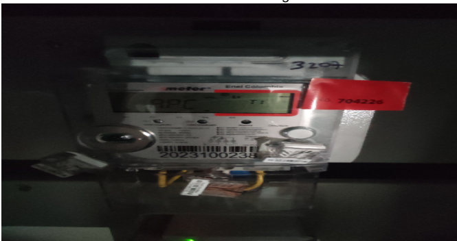
Contador de Energia
