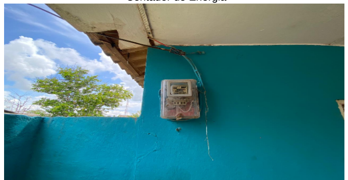
Contador de Energia
