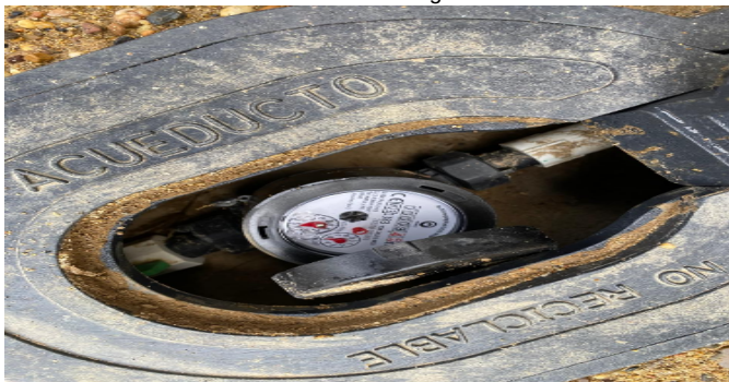
Contador de Agua
