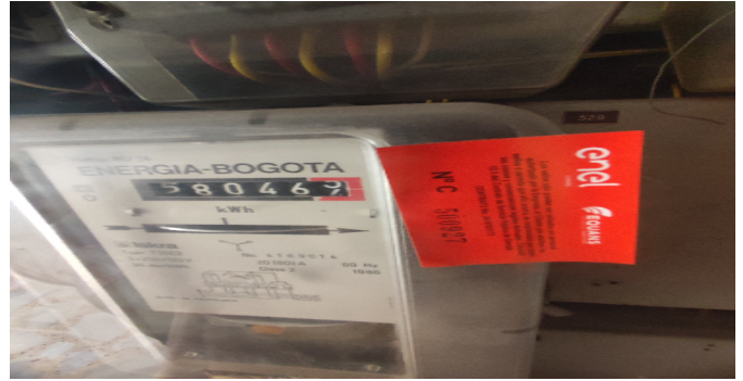
Contador de Energia
