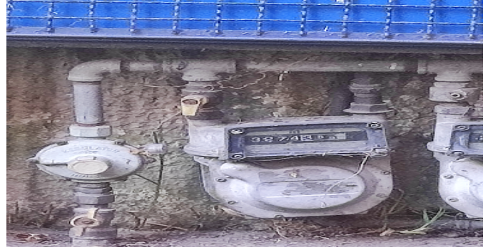
Contador de Gas
