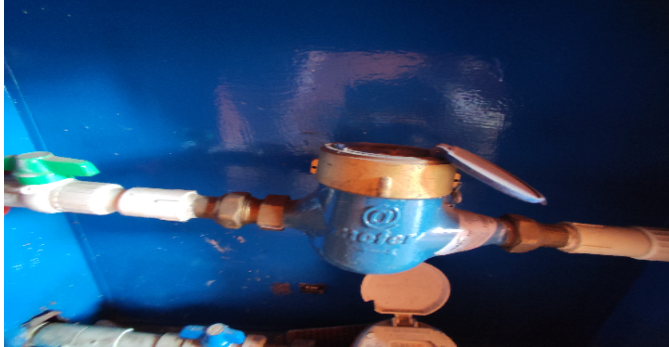
Contador de Agua
