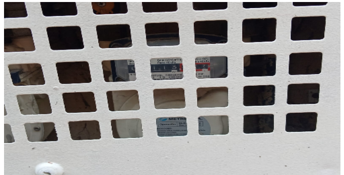
Contador de Gas
