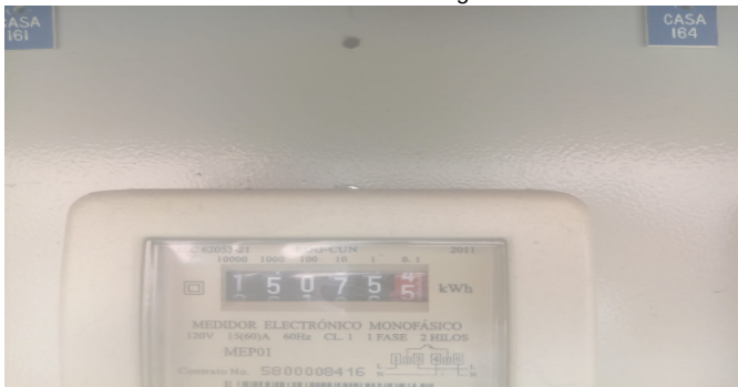
Contador de Energia
