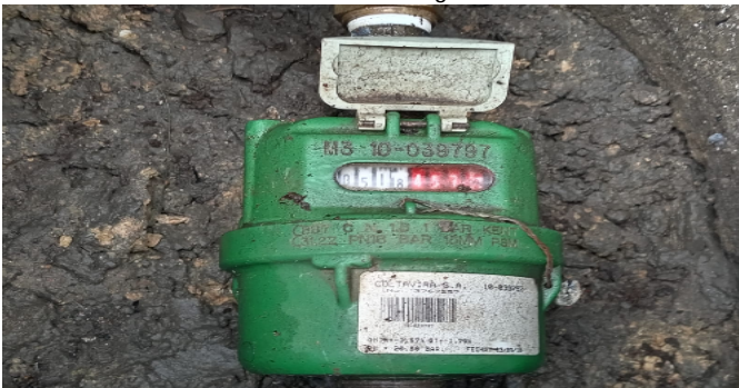
Contador de Agua
