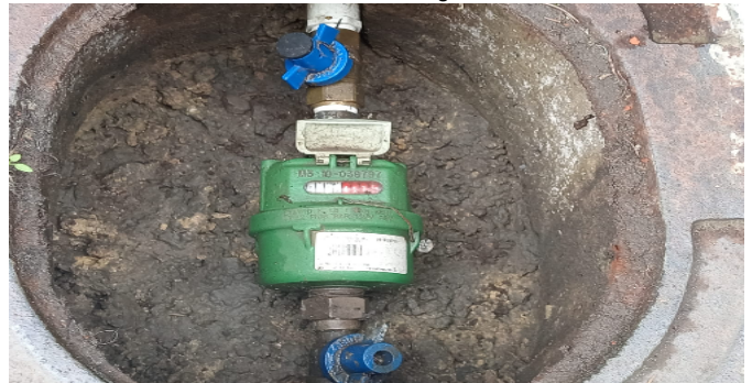
Contador de Agua
