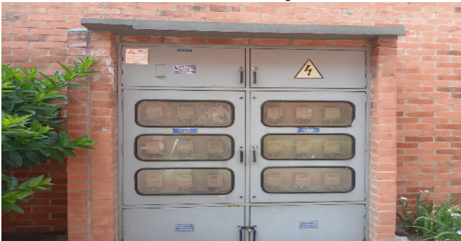
Contador de Energia
