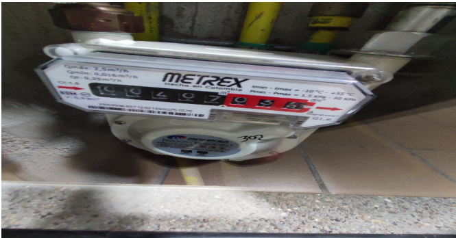
Contador de Gas
