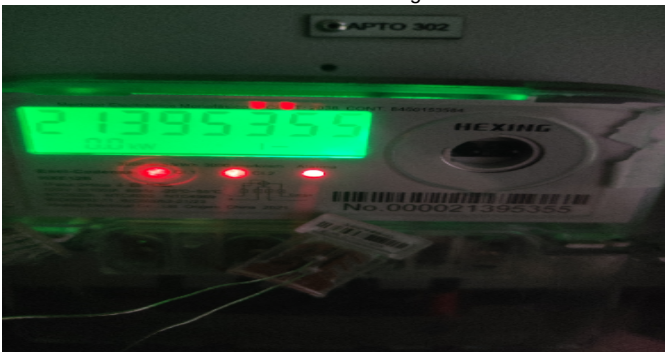
Contador de Energia
