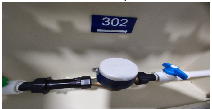
Contador de Agua
