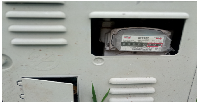
Contador de Gas
