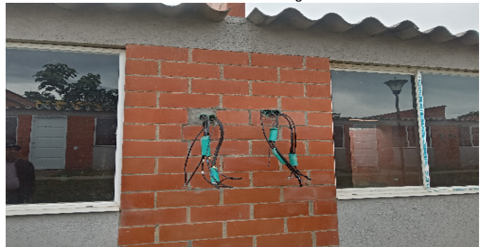
Contador de Energia
