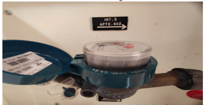
Contador de Agua
