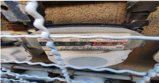
Contador de Gas
