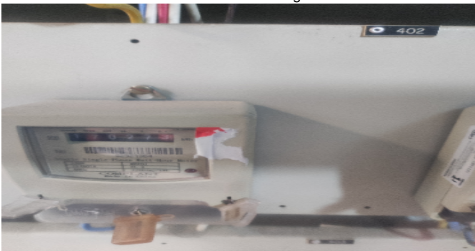
Contador de Energia
