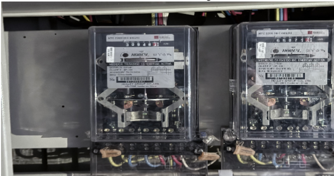
Contador de Energia
