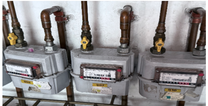
Contador de Gas
