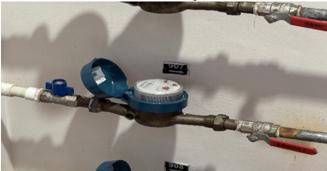
Contador de Agua
