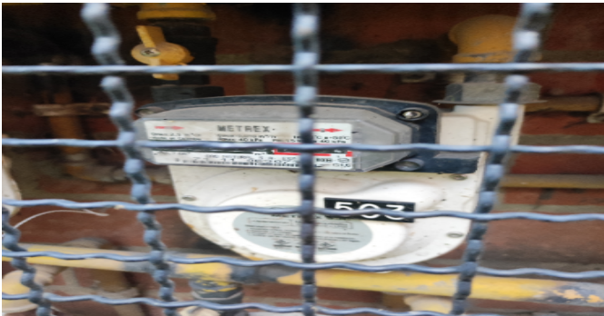
Contador de Gas
