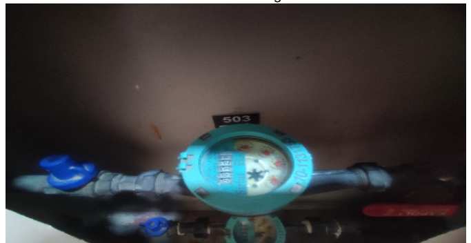
Contador de Agua
