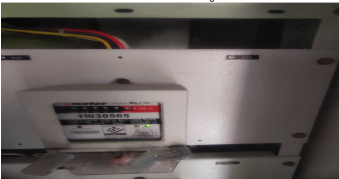
Contador de Energia
