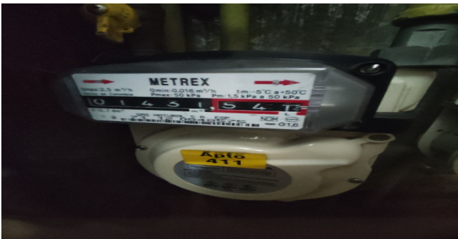
Contador de Gas
