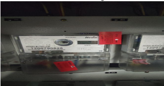
Contador de Energia
