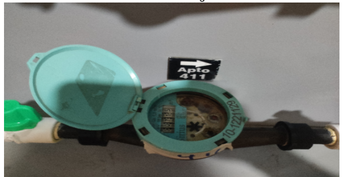
Contador de Agua
