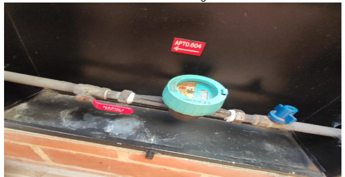
Contador de Agua
