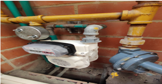
Contador de Gas
