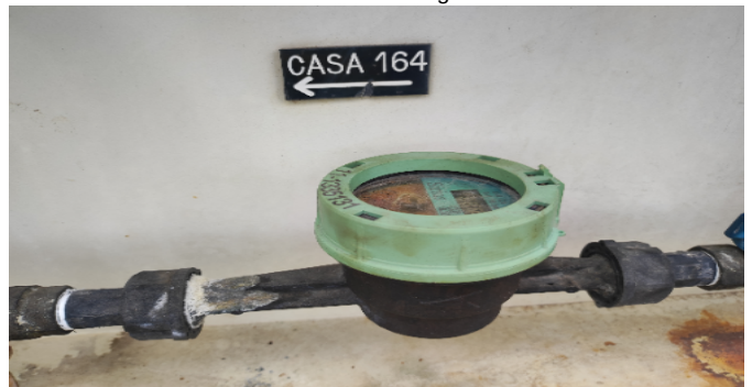
Contador de Agua
