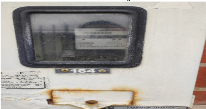
Contador de Energia
