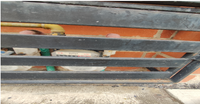
Contador de Gas
