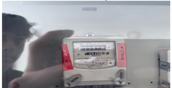
Contador de Energia
