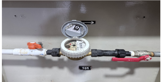
Contador de Agua
