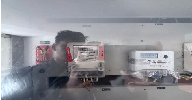
Contador de Energia
