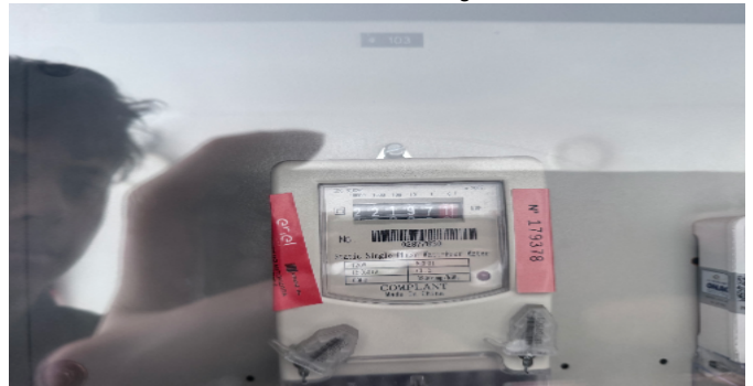
Contador de Energia
