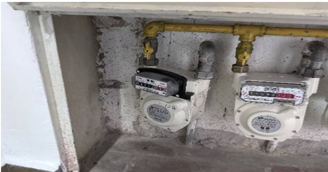
Contador de Gas
