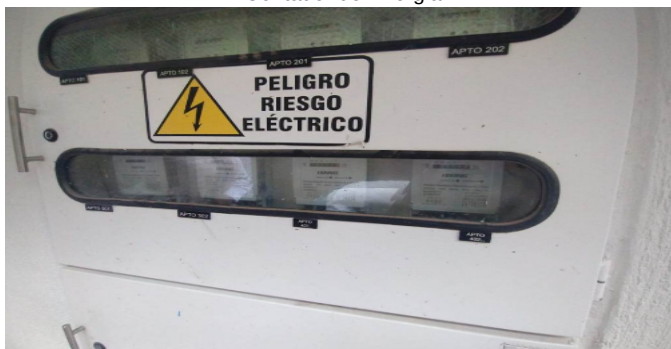
Contador de Energia
