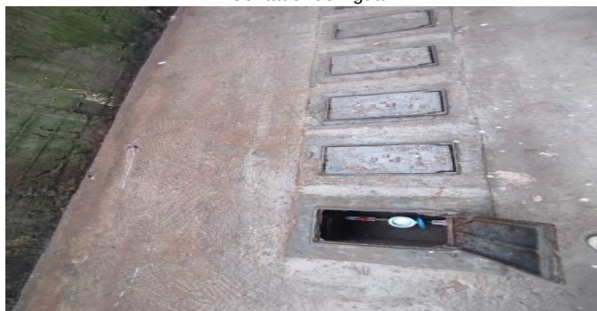
Contador de Agua
