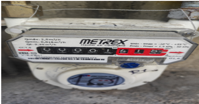
Contador de Gas
