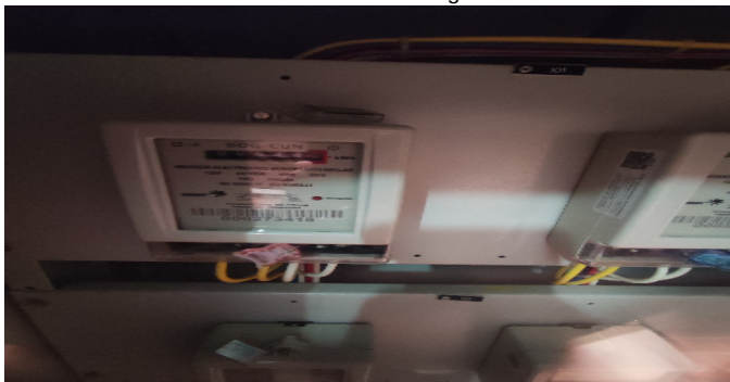
Contador de Energia
