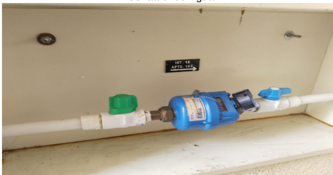
Contador de Agua
