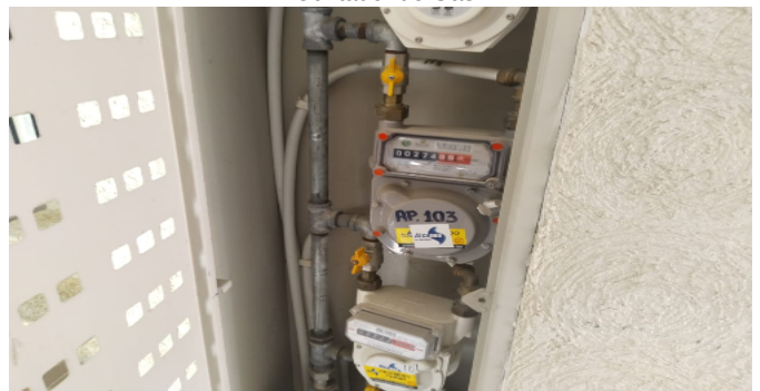
Contador de Gas
