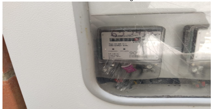
Contador de Energia
